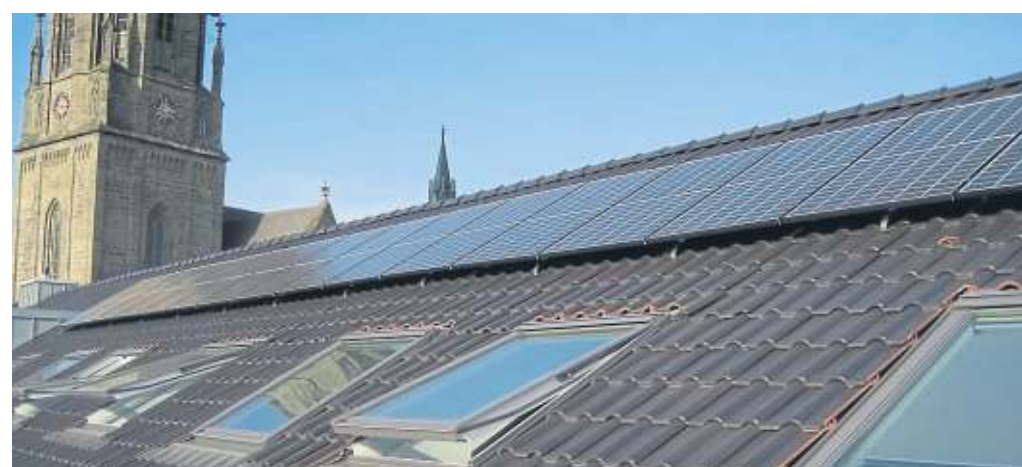
Mit der neuen Photovoltaikanlage auf dem Rathausdach kann bei entsprechendem Wetter eine Gesamtleistung von 9000 Kilowattstunden pro Jahr erzielt werden. FOTOS: RENE TIEFERT
